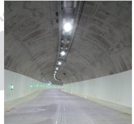
Tunnel, Darmstadt/Deutschland, 2018 Ein- und Durchfahrtsbeleuchtung mit Punktleuchten ▪ Länge: 460 m ▪ Leuchtenzahl: 275 ▪ Steuerung: DALI
