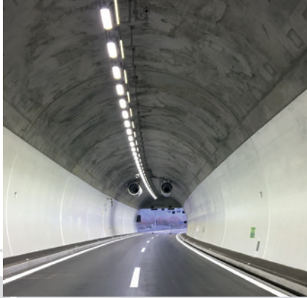
A9 Eyholz, Visp/Schweiz, 2015–2020 Einfahrts- und Durchfahrtsbeleuchtung mit Bandleuchten ▪ Länge: 7400 m ▪ Leuchtenzahl: 6700 ▪ Steuerung: DALI
